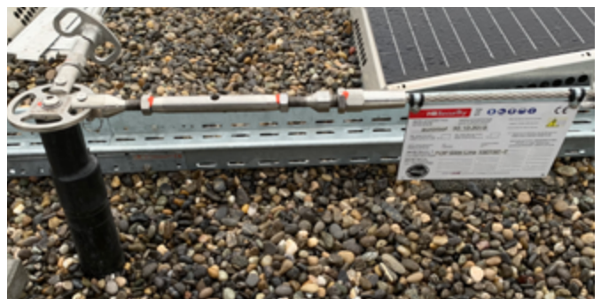
Abb. 42: Objektspezifische Kennzeichnung einer Seilanlage
