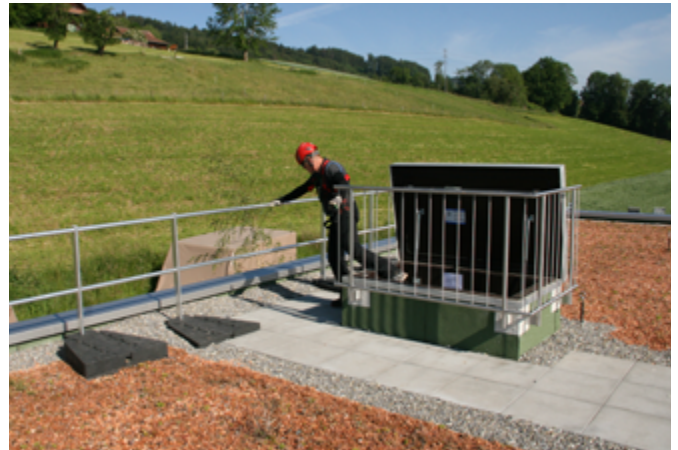
Abb. 36: Dachausstieg durch Seitenschutz aus dem Gefahrenbereich mit hoher Absturzgefahr gesichert. Optimal geplant würde der Dachausstieg in den inneren Gefahrenbereich führen
