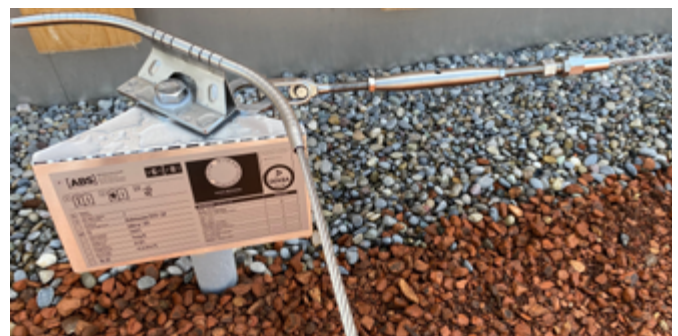
Abb. 43: Objektspezifische Kennzeichnung einer Seilanlage
